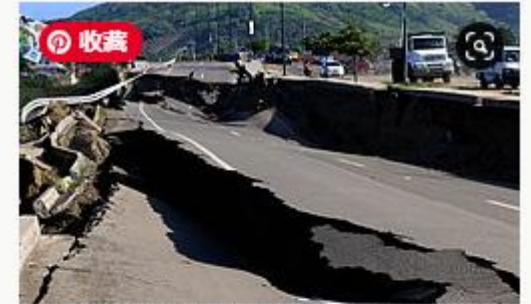
Una parte de la vía Portoviejo-Rocafuerte colapsado luego del terremoto.
